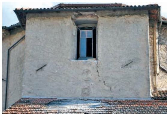
Foto 10: Lesioni sulle muraure perimetrali
