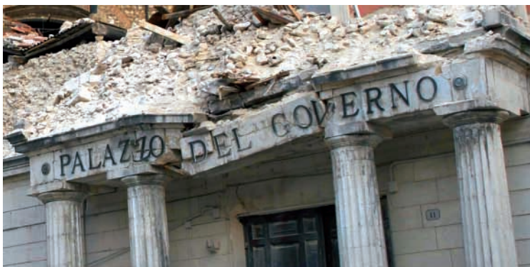
Foto 2: Facciata principale della Prefettura de L'Aquila danneggiata dal sisma.
