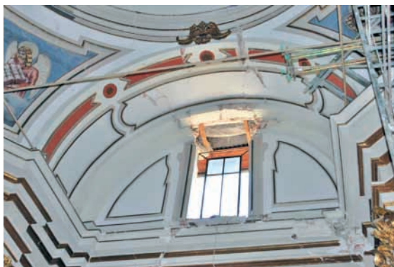
Foto 9: Lesioni alle arcate
